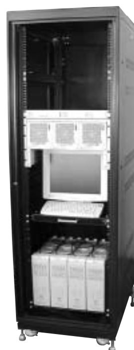
Photo 2 Example of UXF100-12 x 4 in 19" Relay Rack 写真2 UXF100-12 x 4 19インチラック搭載例
