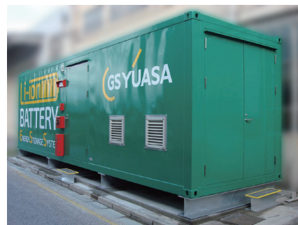
●図 1 コンテナ式電力貯蔵装置の外観
