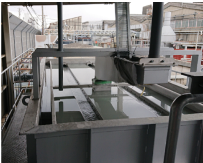
導入した高速沈殿装置
