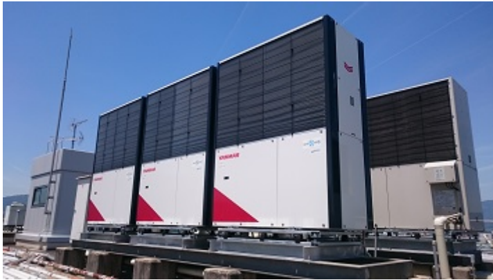
更新した空調機（室外機）
