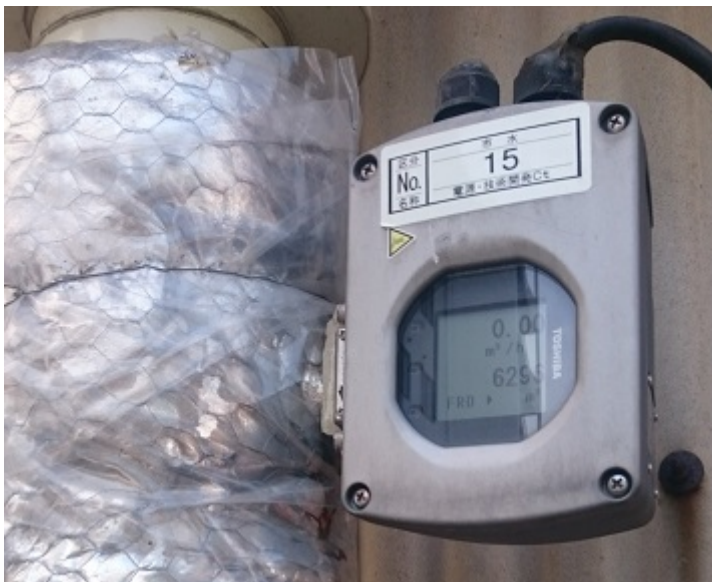
新型メーターによる水使用量の監視
