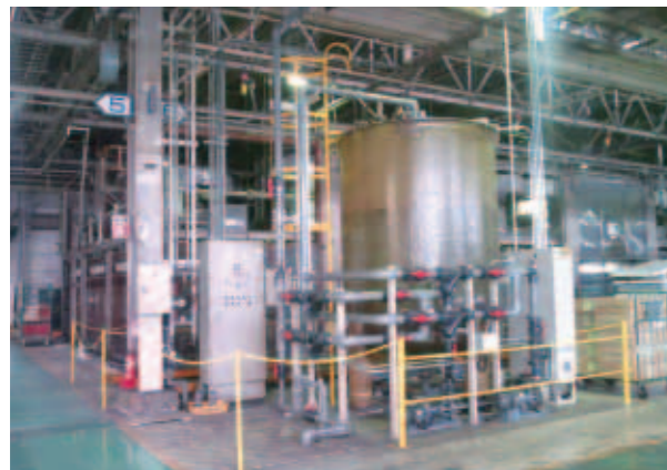
水の循環利用設備
