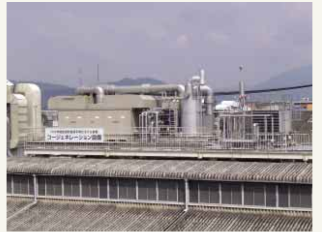
コージェネレーション設備 Cogeneration facility
