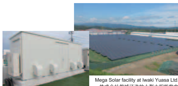
① Photovoltaic inverter 功率调节器
