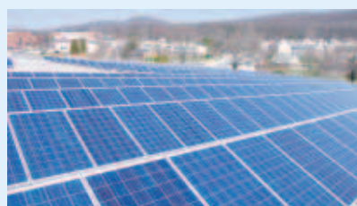
Photovoltaic panel 太阳能板
