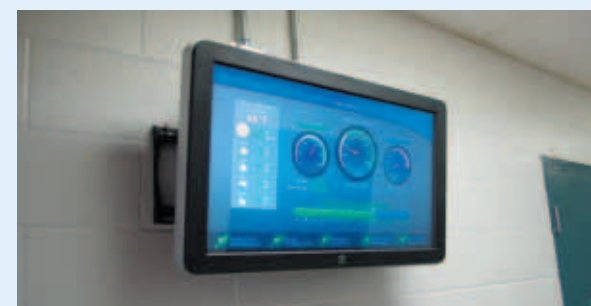
Solar system monitor 太阳能发电系统监视器
